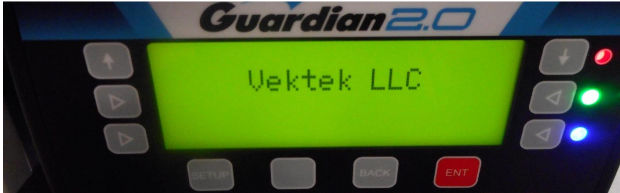
Figure 29: SCREEN: VEKTEK LLC
